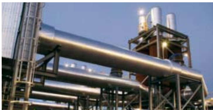
Western 102-laitoksen SCR-reaktoreita.
