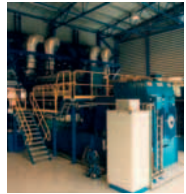
Ecuadorissa sijaitsevan Dygoil-laitoksen kaksi Wärtsilä® 18V32-moottoria käyttävät Fuel sharing-periaatetta
